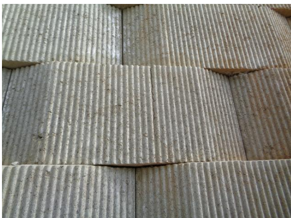
전면부 S5 블록 균열
