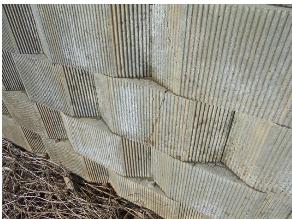
전면부 S2 블록 균열
