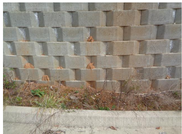
전면부 S5 블록 균열
